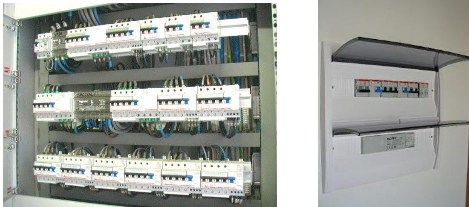
Figura 41. Esempi di quadri elettrici condominiale e da appartamento
